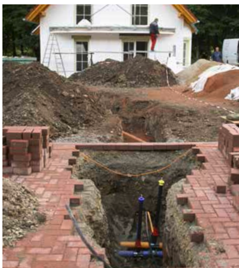
Über den Hausanschluss gelangen die Energie und das Trinkwasser von der öffentlichen Hauptleitung ins Gebäude. Anschlüsse lassen sich einfach online über das Netzanschlussportal der Stadtwerke beantragen.
